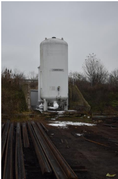
Fot. 16. Wyciek ciekłego tlenu podczas rozładunku autocysterny do zbiornika magazynowego Usuwanie skutków poważnych awarii w środowisku, zanieczyszczenia środowiska
