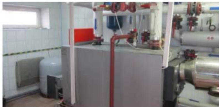
Kotłownia w DPS Koszelewie.
