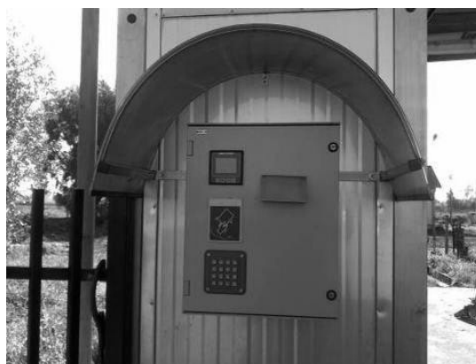
Stacja zlewca na oczyszczalni w Drobinie.
