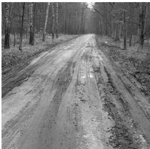
Droga gminna Mościska -Dzierżazna przed przebudową.
